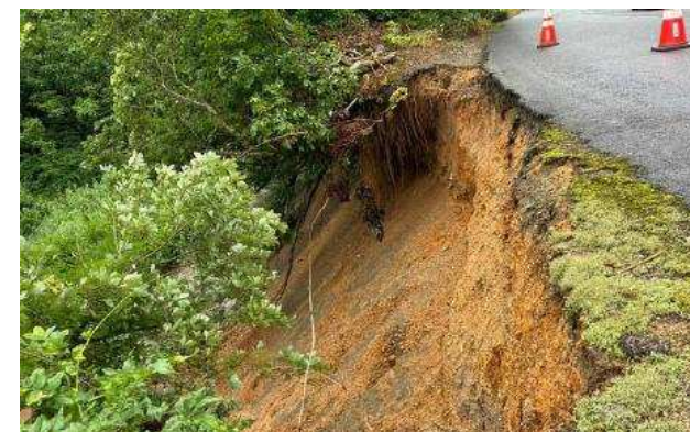
川西小国線 路肩損壊（小国町）
