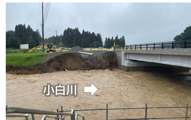
小白川 護岸流出（飯豊町）
