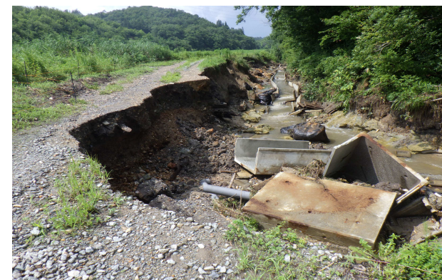
農道、水路の崩落（川西町）
